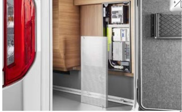
Elektrozentrale in der Rollergarage gut zugänglich
