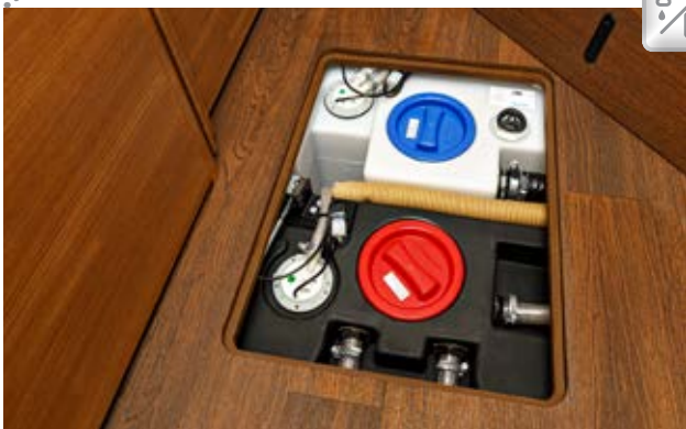
Wassertanks frostsicher im beheizten Doppelboden
