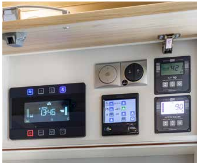
Zentrale Steuerung, gut sichtbar und einfach zu bedienen
